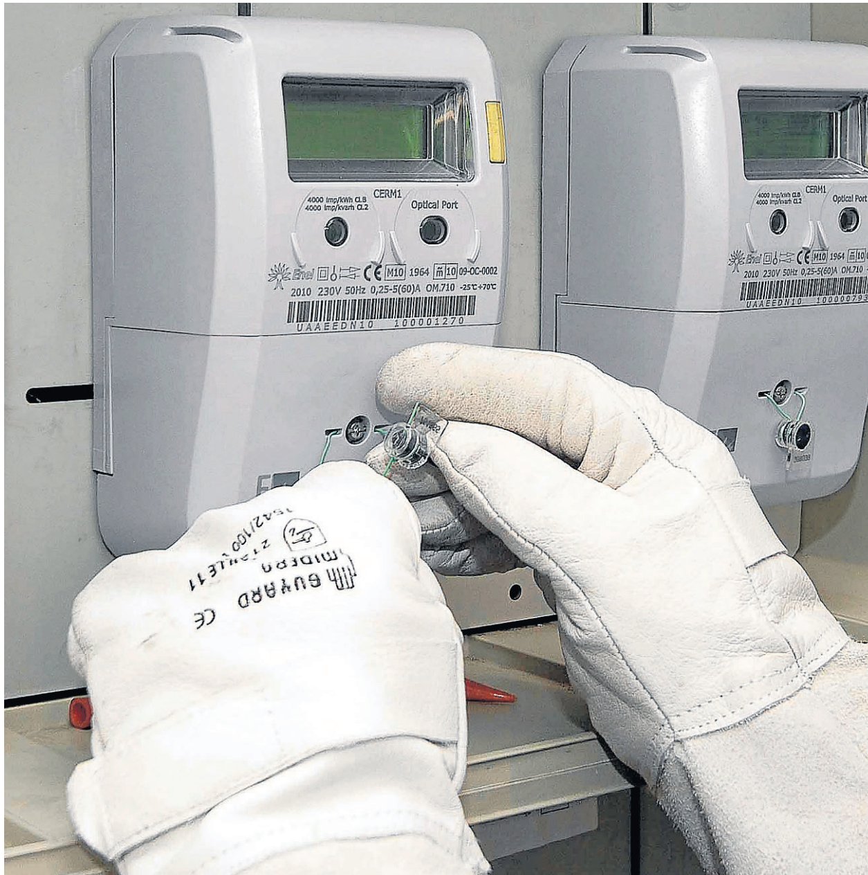
La instalación de los contadores de la luz de telegestión debe completarse antes de que finalice 2018. ENDESA
